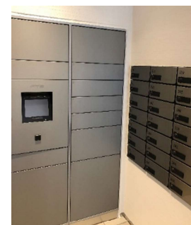
宅配ボックス
