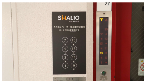
エレベータ案内板（槇塚台団地）
